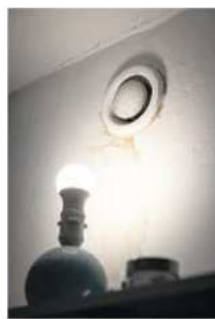
Feuchte Wand in einer Hölk-Wohnung
